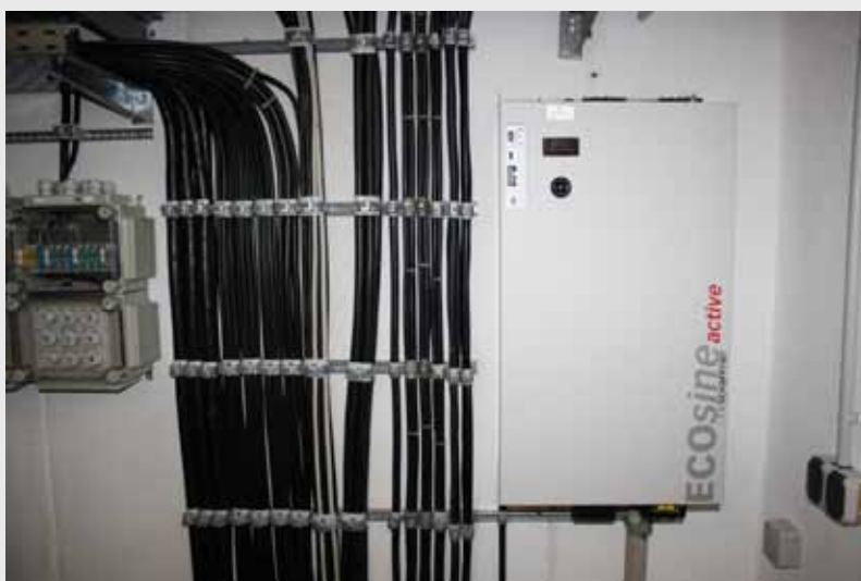
In Sendeanlage installierter Schaffner-Aktivfilter FN 3420
