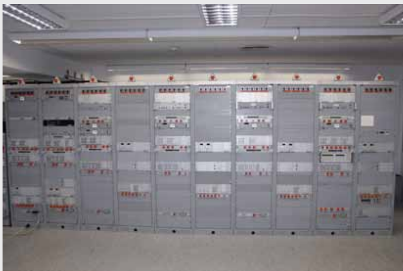
Teil einer Radio-Sendeanlage
